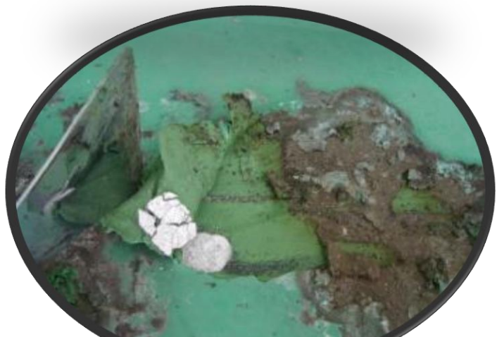
防水材の硬化不良
